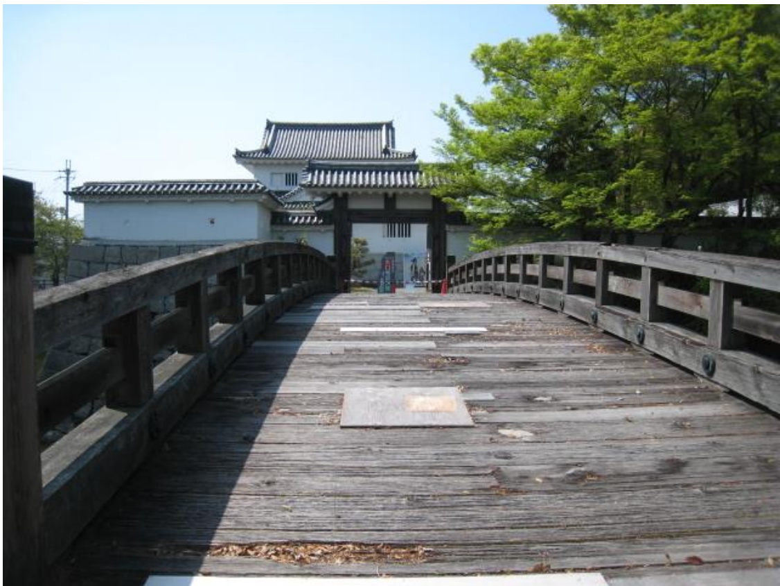
水口城跡の玄関橋(木造)現在危険のため通行禁止
